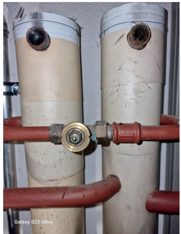
Aanvoer van de stadsverwarming. De klep stond 100% open.
