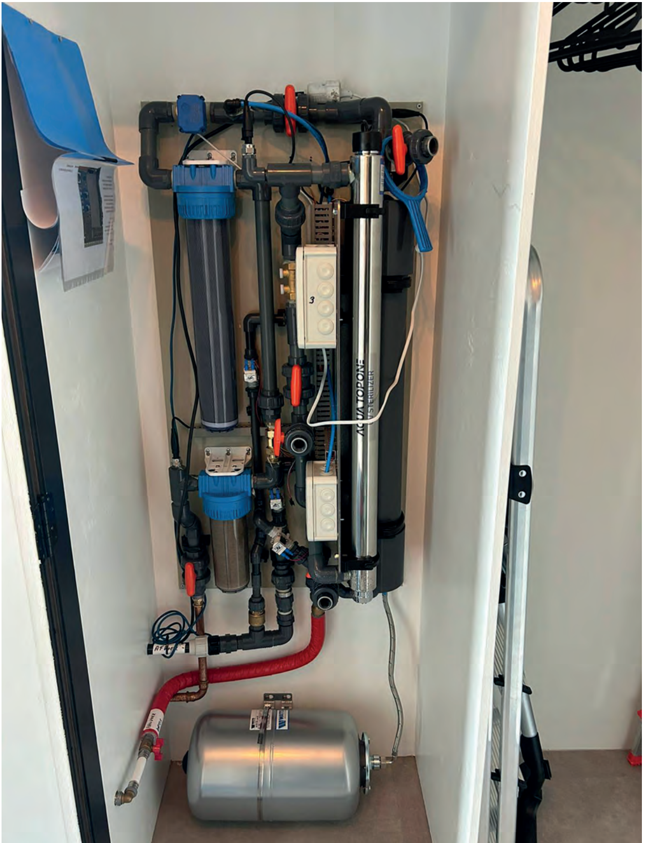
De techniek, nodig om het regenwatersysteem aan te sturen, past in een gangkast, een schuur of een garage.
