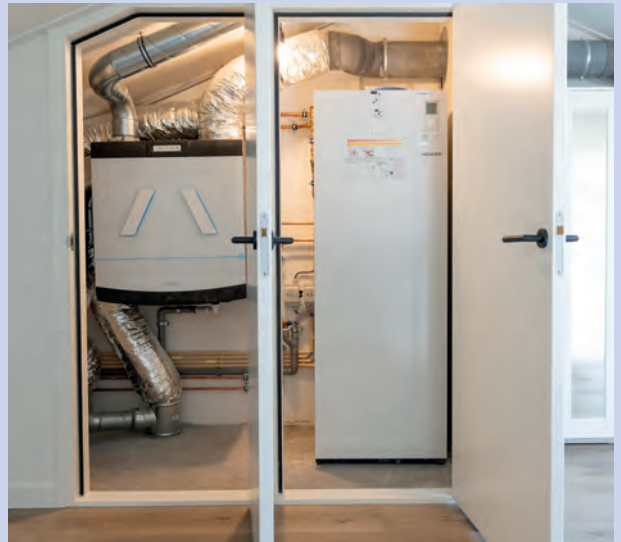
Het koningskoppel: Orcon HRC EcoMax en Atlantic Alfea Extensa lucht/water warmtepomp.
